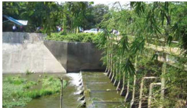
河川水位監視センサーを設置したフィリピン・マッサム川
