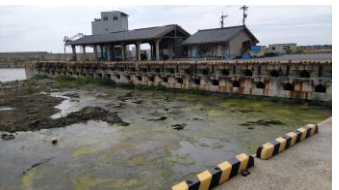
石川県輪島市門前町 鹿 磯漁港（かいそぎょこ う） 漁港内部の海底が 大きく隆起 (2024年7月19日撮影)
